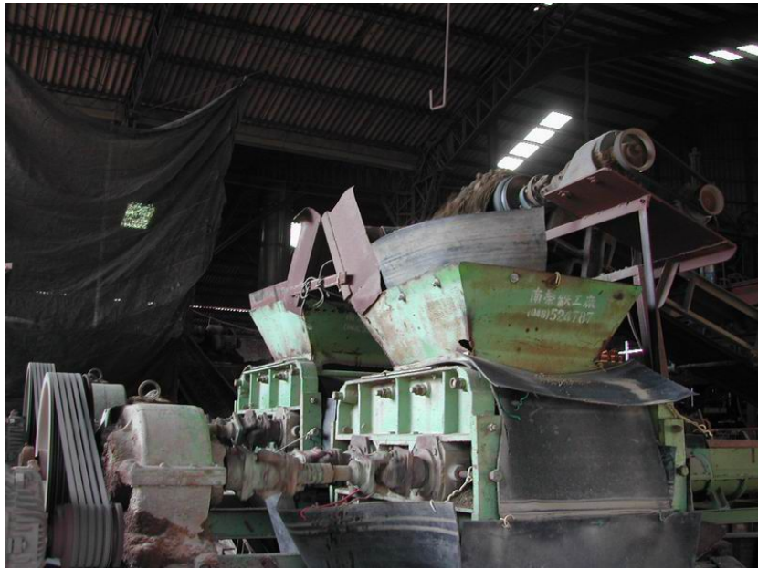
圖一、碎土機、鋼網式碎粉機：粉碎原土、磚坯 (不良品)及燃料(煤炭)
